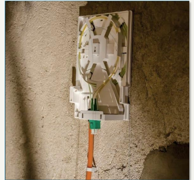
Anschluss im Keller/Technikraum
